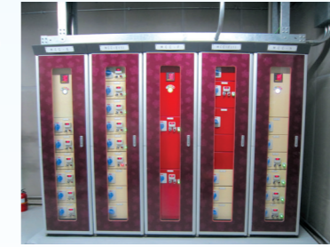
소방용 MCC 패널
